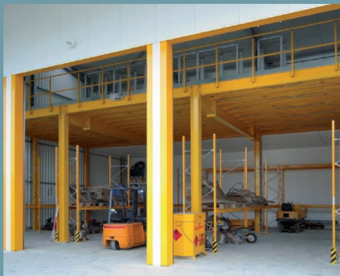
Afgestemd op de voorhanden zijnde halafmetingen. Opslagplatform met rekken onderaan en op het opslagplatform.
