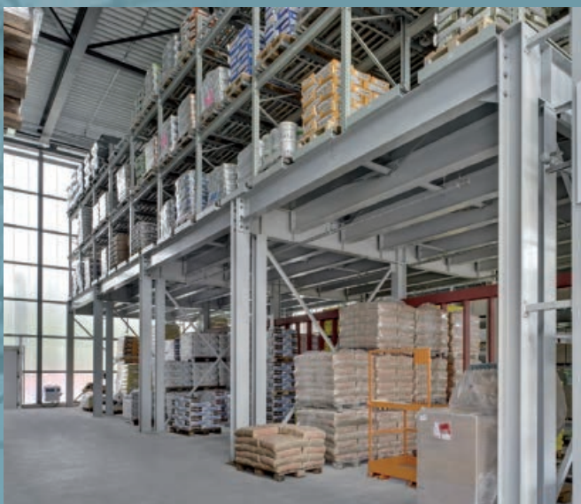
Robuust staalbouw opslagplatform in het grondstoffenmagazijn. Hier met geïntegreerde transporttechniek.
